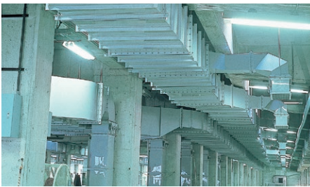
下水処理場 換気・防臭用ダクト (押出プレート)
